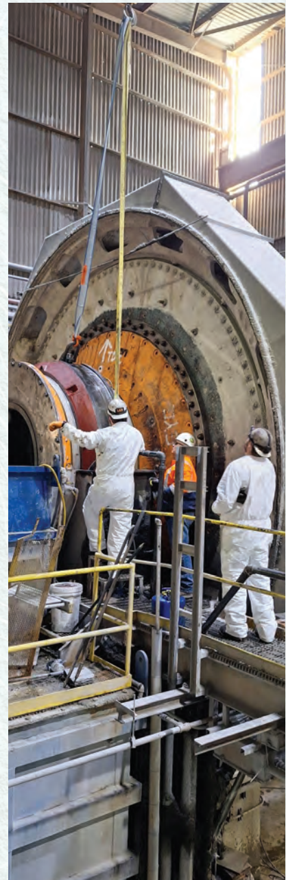
Equipo de mantenimiento de planta, Pinto Valley
