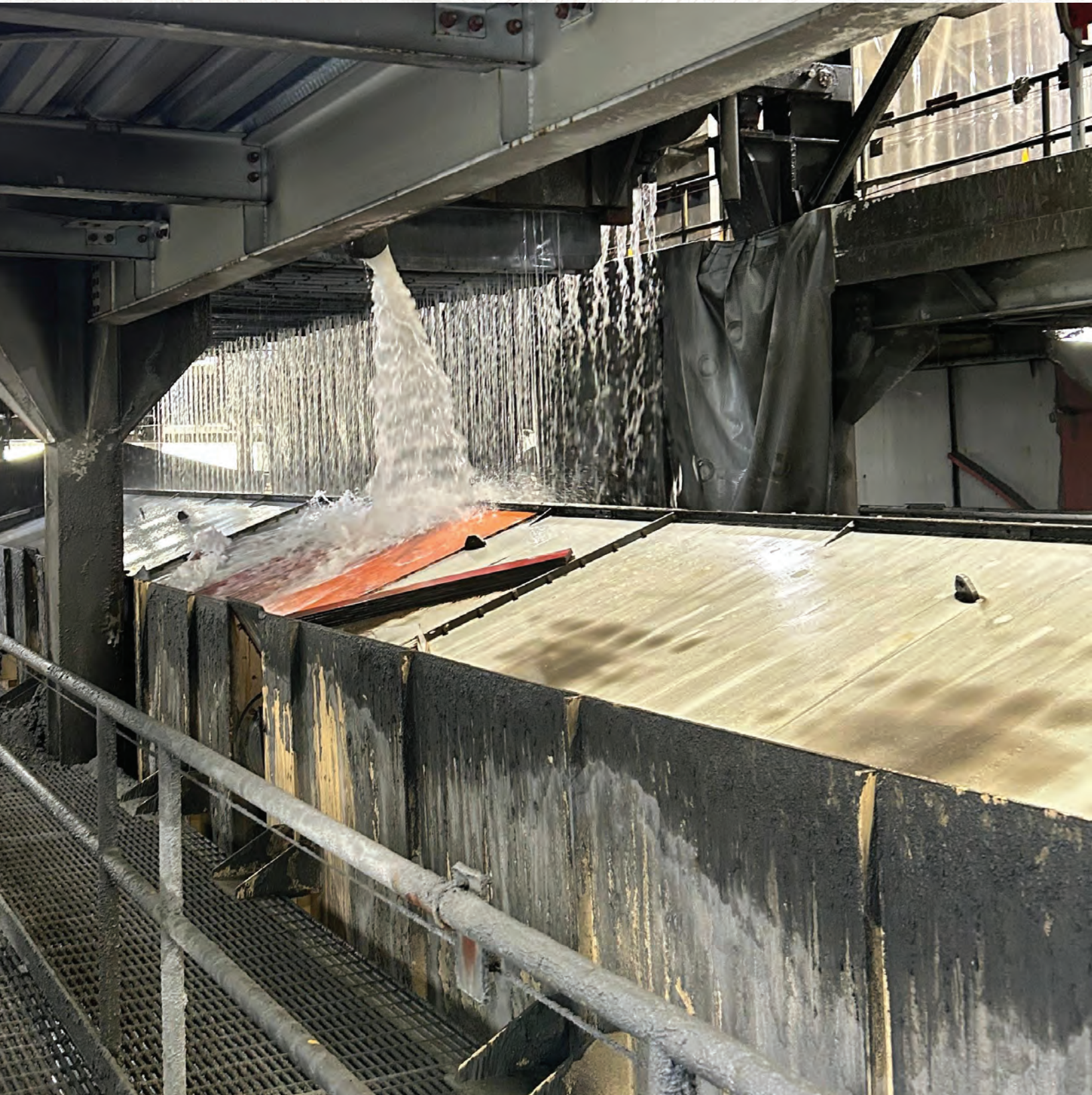
Recuperación de agua en la planta de relaves en seco, Cozamin
