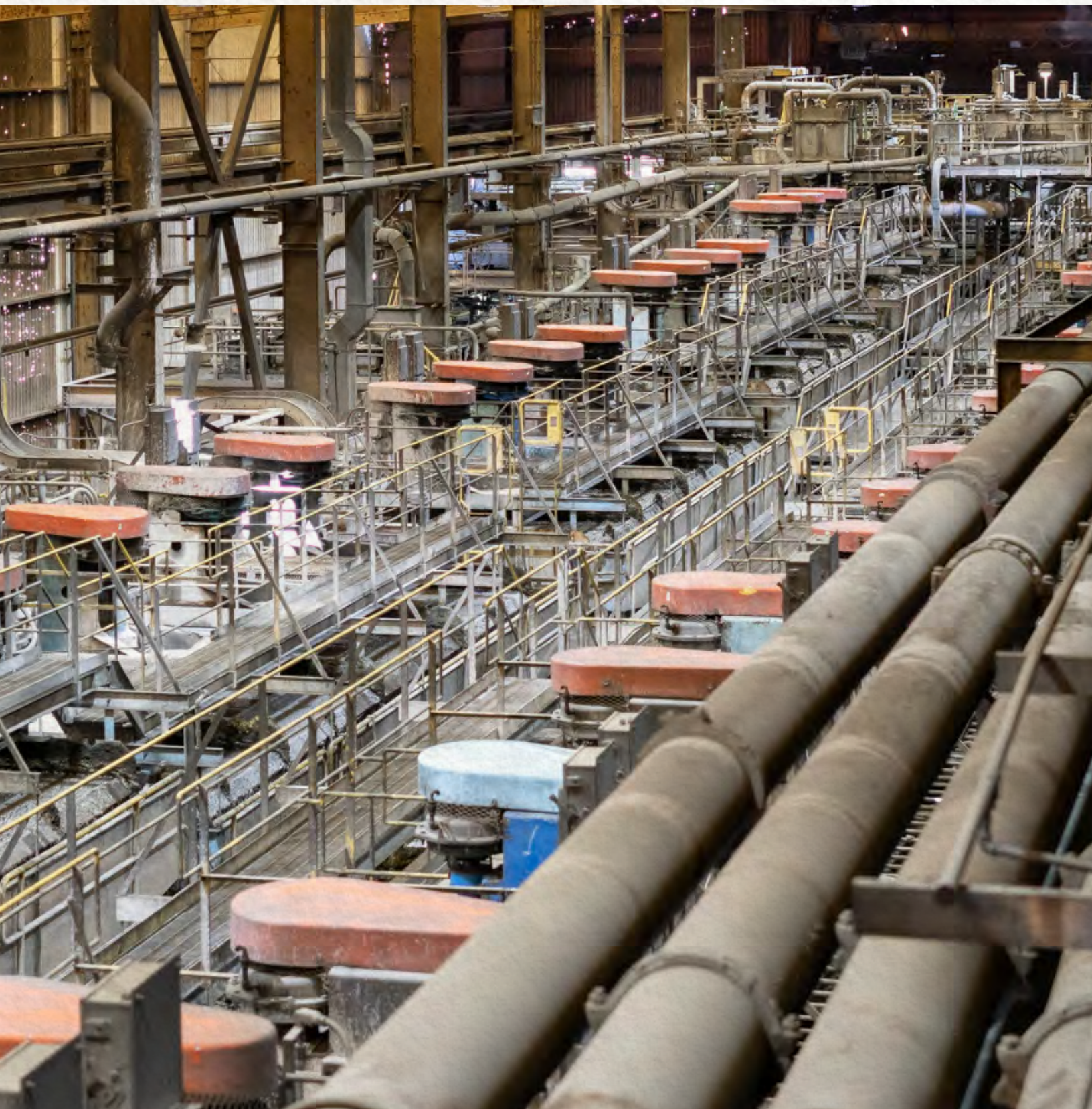
Pinto Valley – planta de extracción por solventes y electroobtención (SX/EW).
