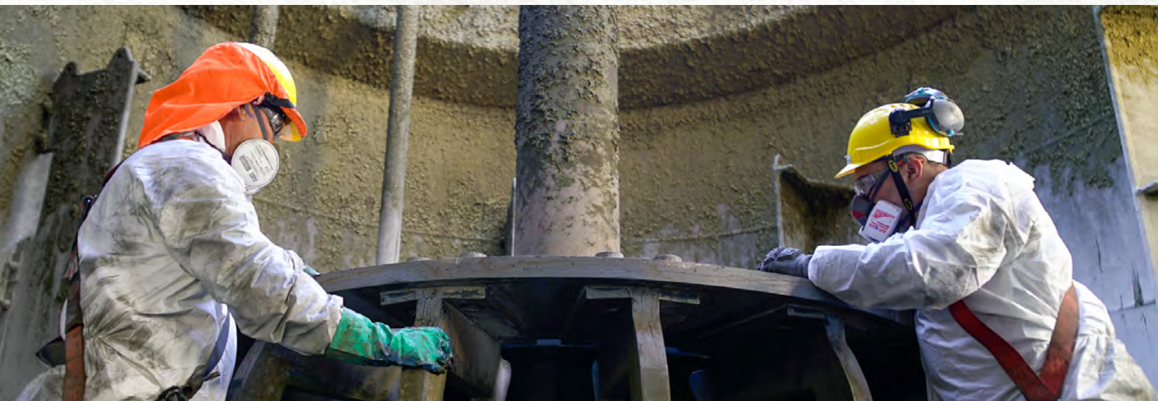
Mantoverde – mantenimiento de planta.
