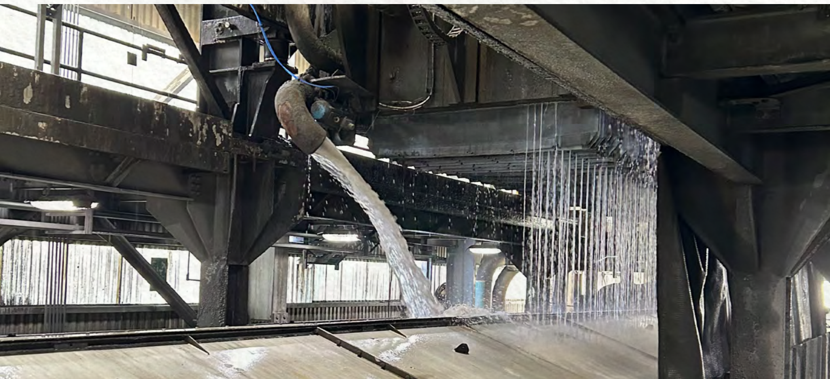
Cozamin - recuperación de agua en planta de relaves secos.
